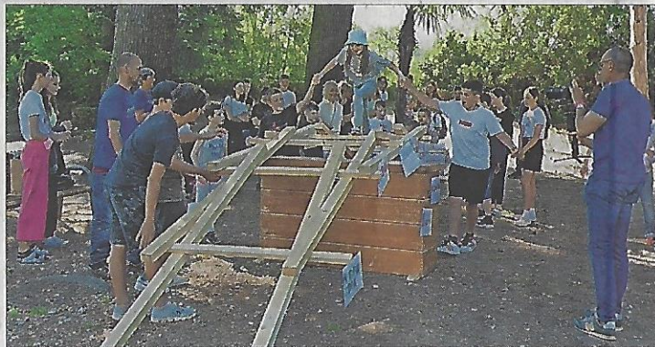
Die Klasse 2A der Mittelschule Mariengarten baute nach Plänen Leonardo da Vincis und unter der Leitung des Techniklehrers Michael Paler eine mobile Brücke (im Bild).
